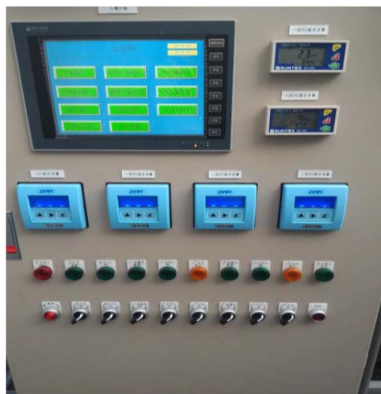
圖6.某工業區某石化廠之水回收處理系統Pilot 模型廠HMI操作面板
