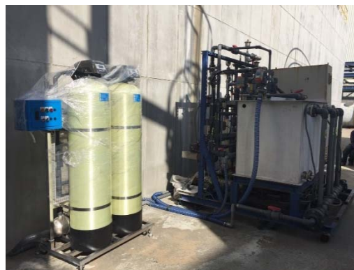
圖4.某工業區某石化廠之水回收處理系統Pilot 模型廠(前處理及UF)
